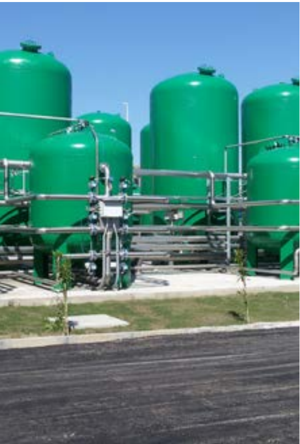
Impianto trattamento acque di falda cariche di metalli Treatment plant of groundwater loaded with metals
