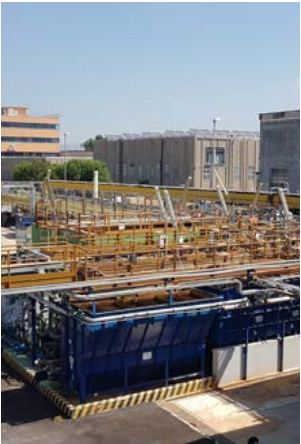
Impianto di trattamento delle acque provenienti dal processo industriale Water treatment plant from the industrial process
