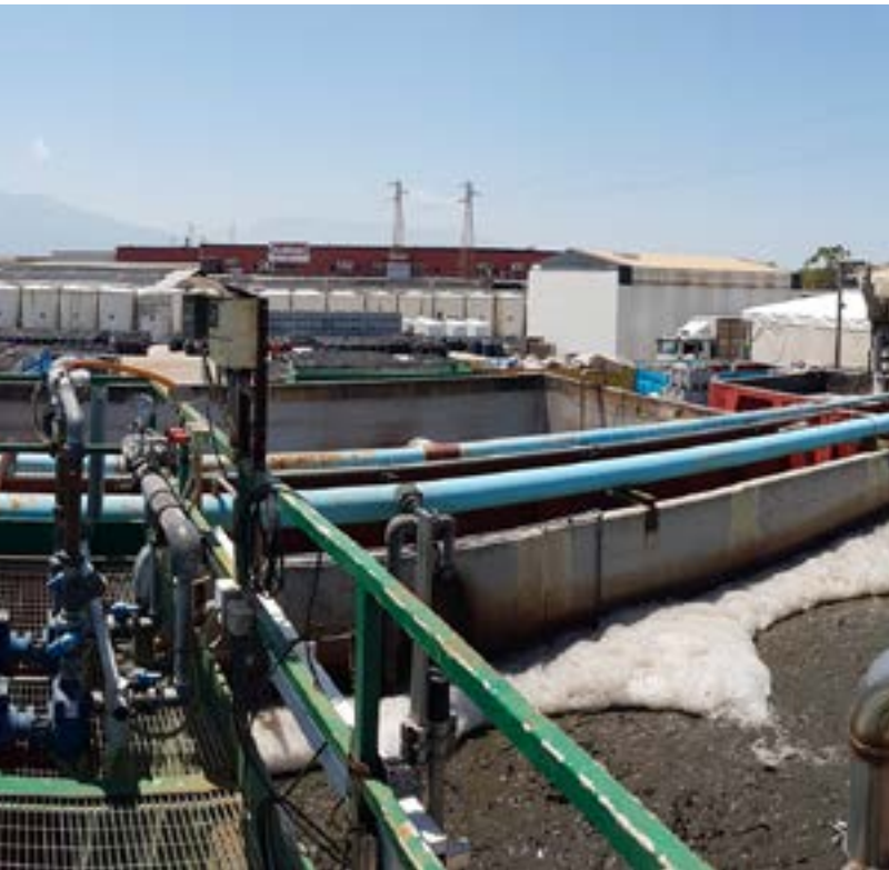
Impianto di trattamento acque di processo industria alimentare Water treatment plant for food industry processing
